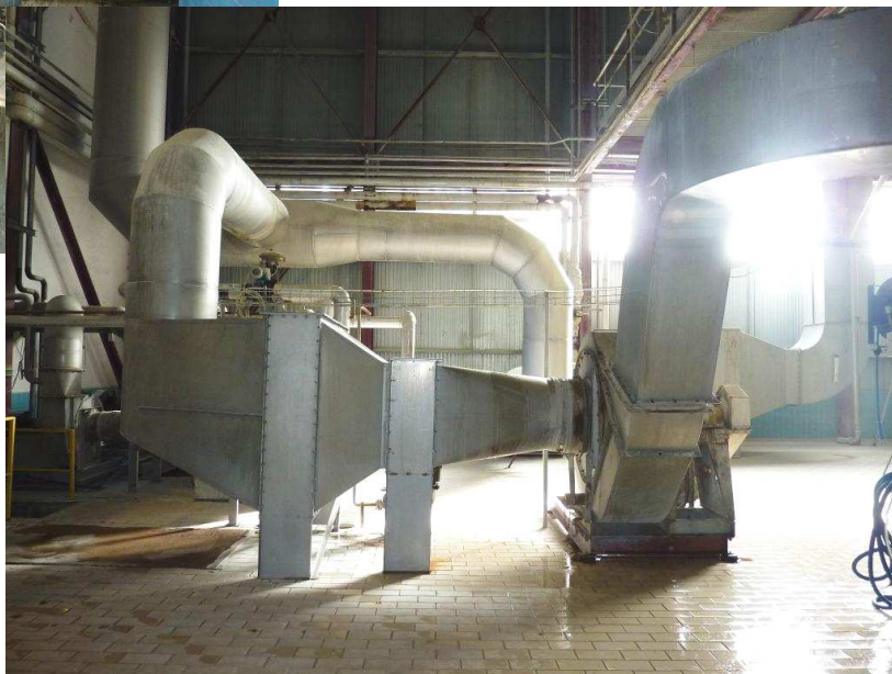
Photo 4 (à droite) : Vue d'installations de traitement de l'air au RDC
