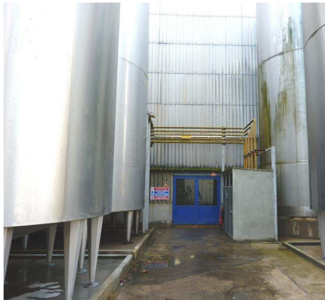
Photo 18 : Sortie en aérien du réseau gaz, poste de détente et distribution vers tours d'atomisation
