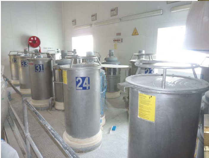
Photo 15 (à droite) : Vue de hauts de cellules avec alimentation par transport pneumatique et filtre ponctuel sur cellules
